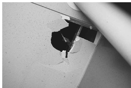
写真3 破損したベランダの天井
