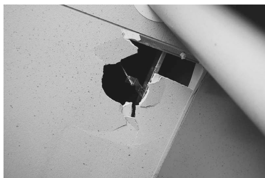
写真 3 破損したベランダの天井
