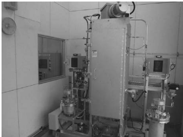
写真 6. PCB 吸着分離装置 全体像
