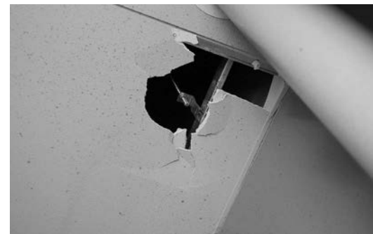
写真3 破損したベランダの天井
